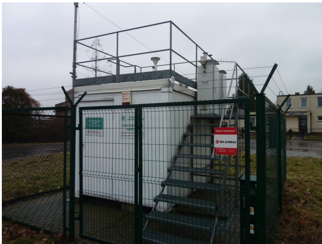
Stacja monitoringu powietrza przy ul. Szklarniowej w Nisku
